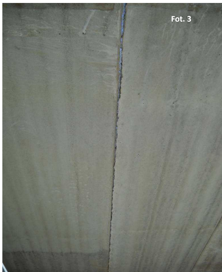
Fot. 2,3 Widok stropu wykonanego z płyt HC z widocznymi dopuszczalnymi wyszczerbieniami technologicznymi dolnej krawędzi płyty ciętej zarówno metodą „na mokro” jak i „na sucho”
