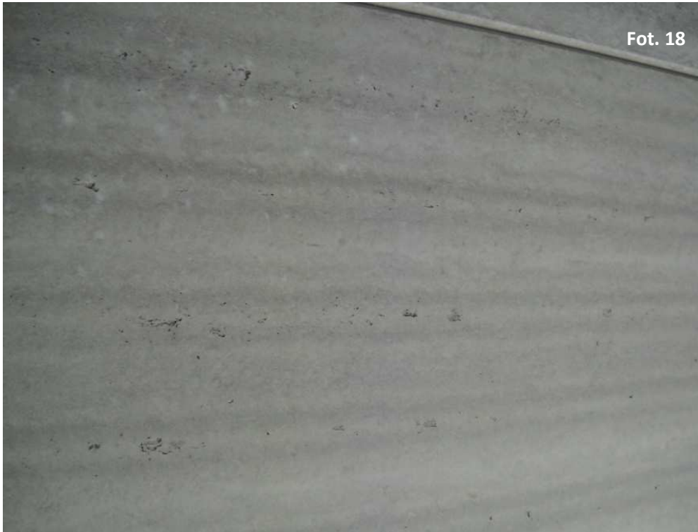
Fot. 18 Niepodlegające naprawie drobne pory widoczne na dolnej powierzchni płyt stropowych
