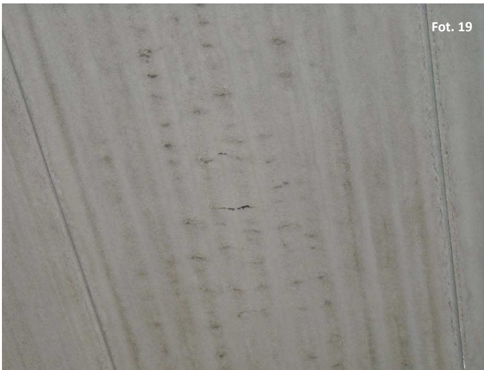
Fot. 19 Niepodlegające naprawie drobne niedowibrowania betonu na dolnej powierzchni płyt stropowych
