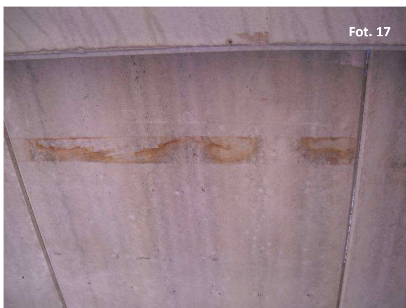
Fot. 16,17 Widok odcisniętych podkładek drewnianych na dolnej powierzchni płyt stropowych
